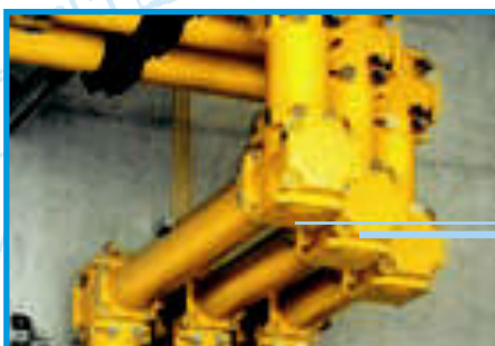
GL 12 kV – 2500 A
