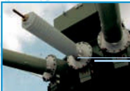
DTO1 123 kV – 1250 A
