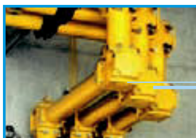
GL 12 kV – 2500 A
